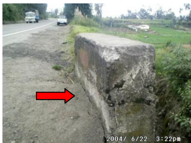
Punto de impacto sobre muro de concreto
