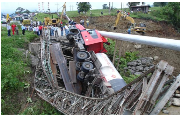
Figura 1. Accidente fortuito por desplome de un puente,
