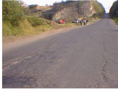
Calzada asfaltada seca irregular (baches).
